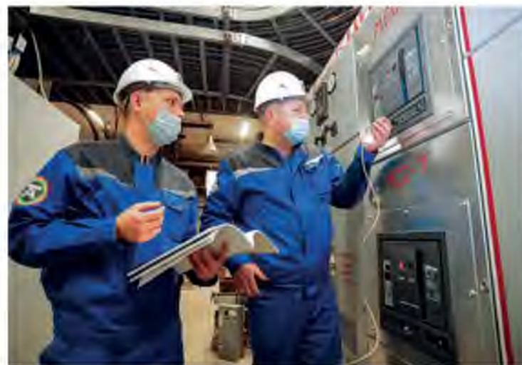
Участок по наладке электроустановок в ответе за их бесперебойную работу
